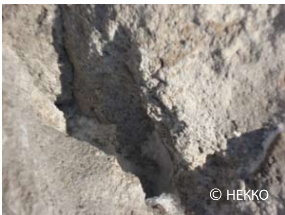
Каверна, намытая в бетонном блоке.
